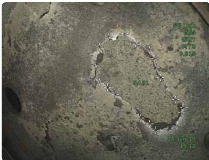
Zona de medición
